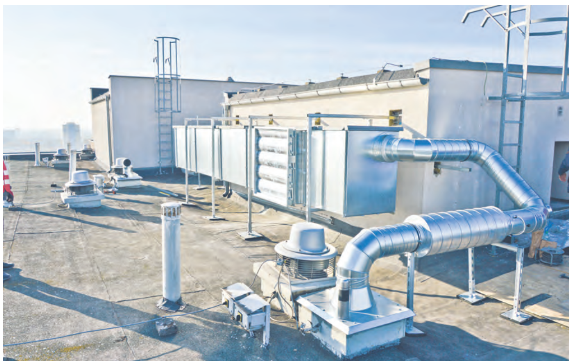
Fragment instalacji na dachu budynku na Os. Tysiąclecia 70
